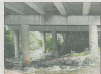
El riu a Figaró amb un nou mur d'escullera al fons i restes de troncs de 1994
