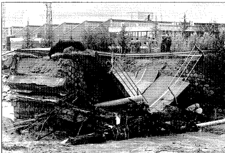
El pont de la carretera de Sabadell a Lliçà de Vall no va poder aguantar la força del Tenes
